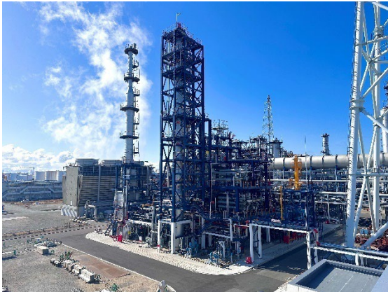
完工した SAF 製造装置
