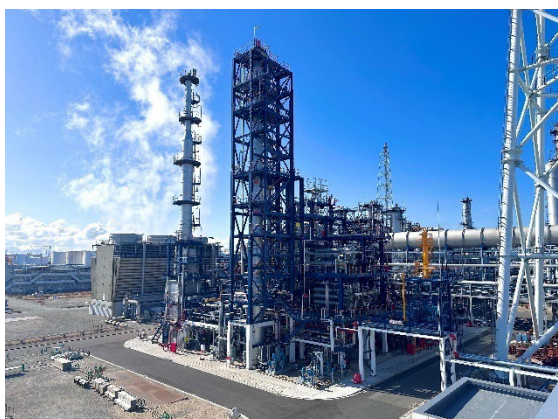
完工した SAF 製造装置
