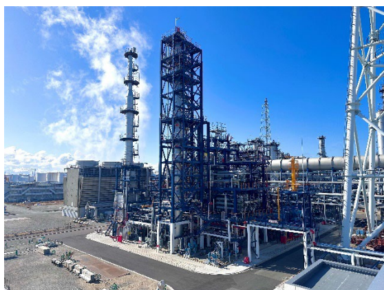
完工した SAF 製造装置
