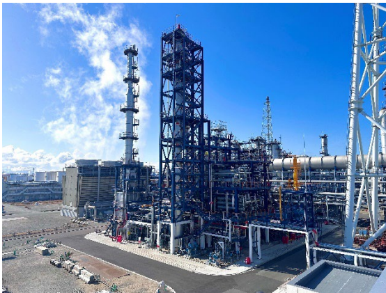
建設が完了した SAF 製造装置 (コスモ石油堺製油所構内)
