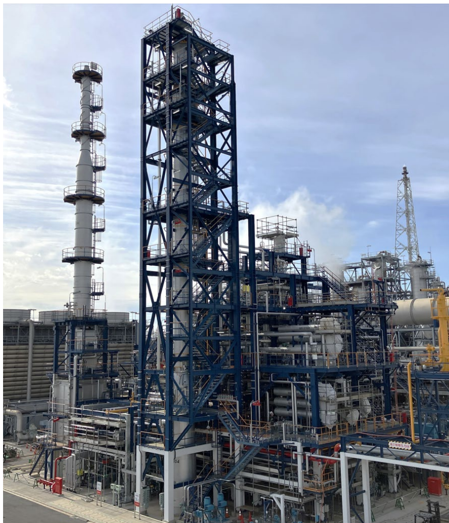
完工した SAF 製造設備（2024 年 12 月撮影）
