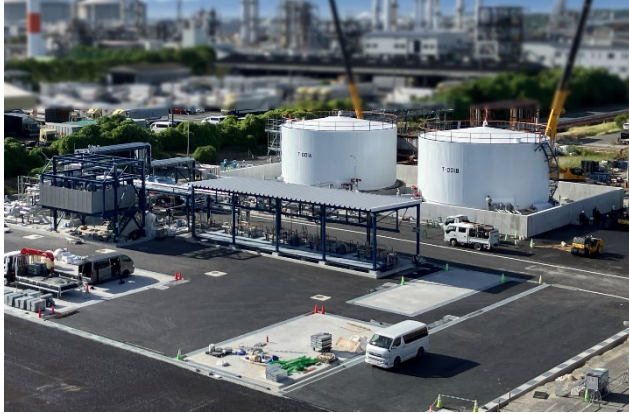
原料（廃食用油）の受け入れ設備
