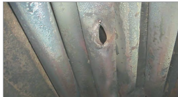
加熱炉チューブのクリープ破断
