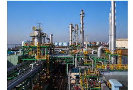
CCS 実証設備
