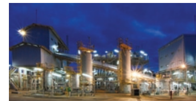
JCF®製造実証プラント
