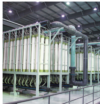
海水淡水化設備
