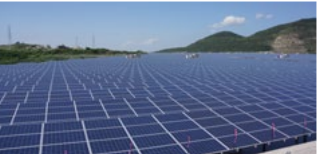
（株）富津ソーラー社向けメガソーラー発電所（千葉県）
