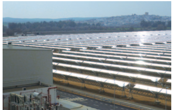
太陽熱発電設備(スペイン)
