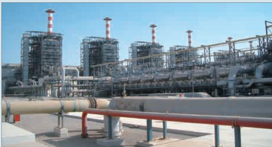
日揮が出資する事業会社が運営するアブダビ発電・造水設備
