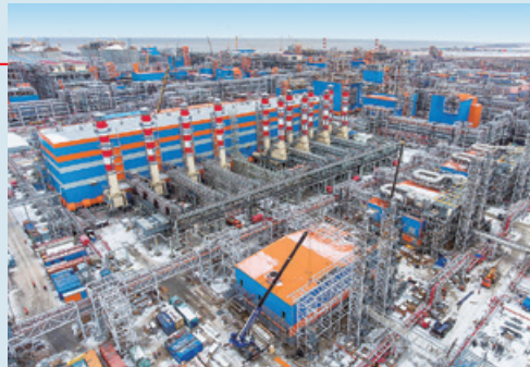
ロシア向けLNGプラント
